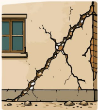
grietas estructurales importantes,
